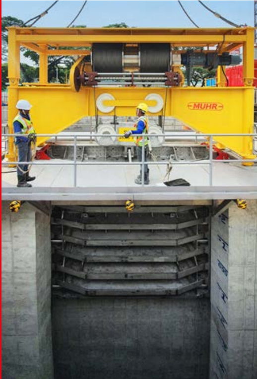
Großes Ding #2: Absperrorgane für das Abwasser- system einer asiatischen Millionenstadt.
